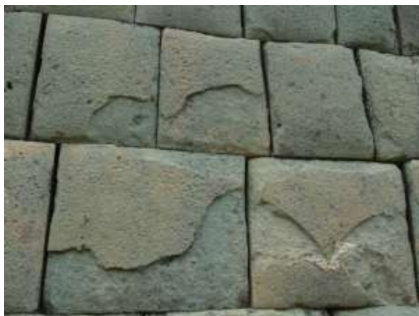
Figura 9. Exfoliación gruesa o desplazamiento
