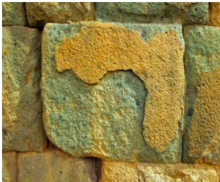
Figura 67. Patología de desplazamiento o exfoliación laminar gruesa
