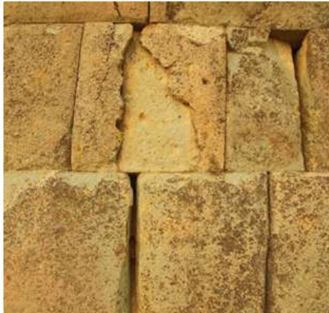
Figura 13. Desprendimientos y fisuras
